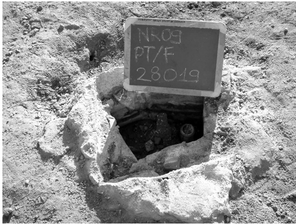
Figura 8 – PT/F: pozzetto di scarico.
