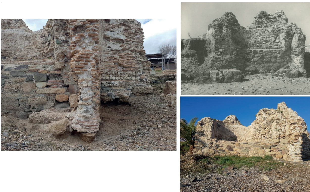
Fig. 4. Pula, Nora. Alcuni fenomeni erosivi nelle terme di Levante e muro realizzato da Pesce a sostegno della vasca absidata in una foto d'archivio e oggi.
